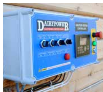
Forenkling: Dette systemet er det få av i Norge. Det blåser luft ned i gjødselkjelleren, og gjør at bonden slipper å røre når han skal ut med husdyrgjødsel.
